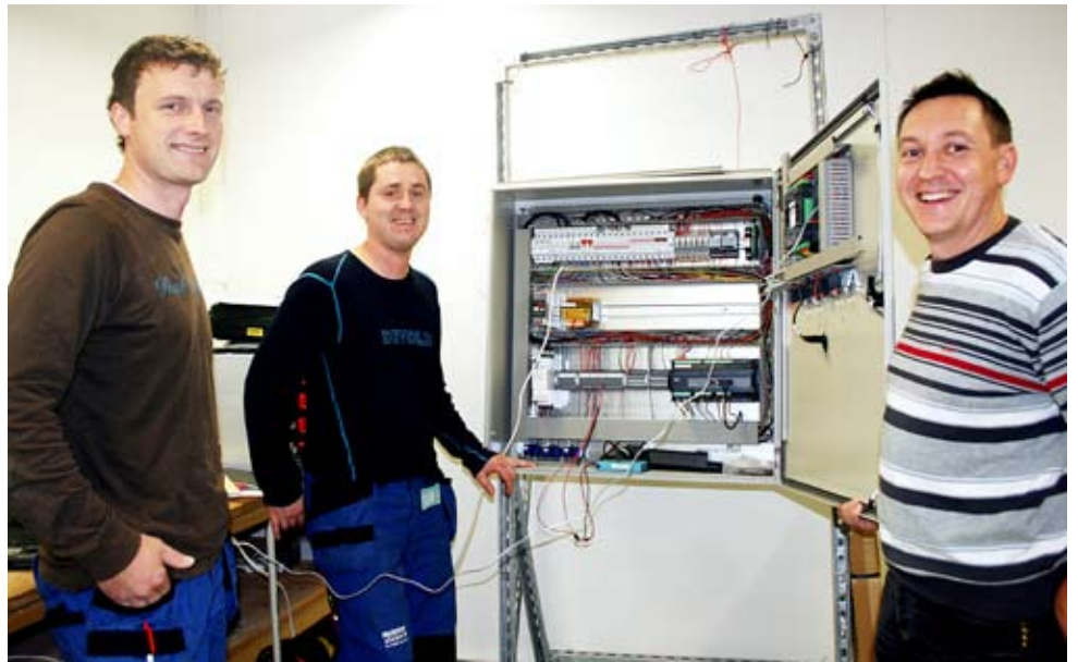
Tekniker Willy Asbjørn Lunde, Asle Lysholt og installatør Svein Tore Veim med skapet med styresystemer som skal til et minikraftverk i Volda.
