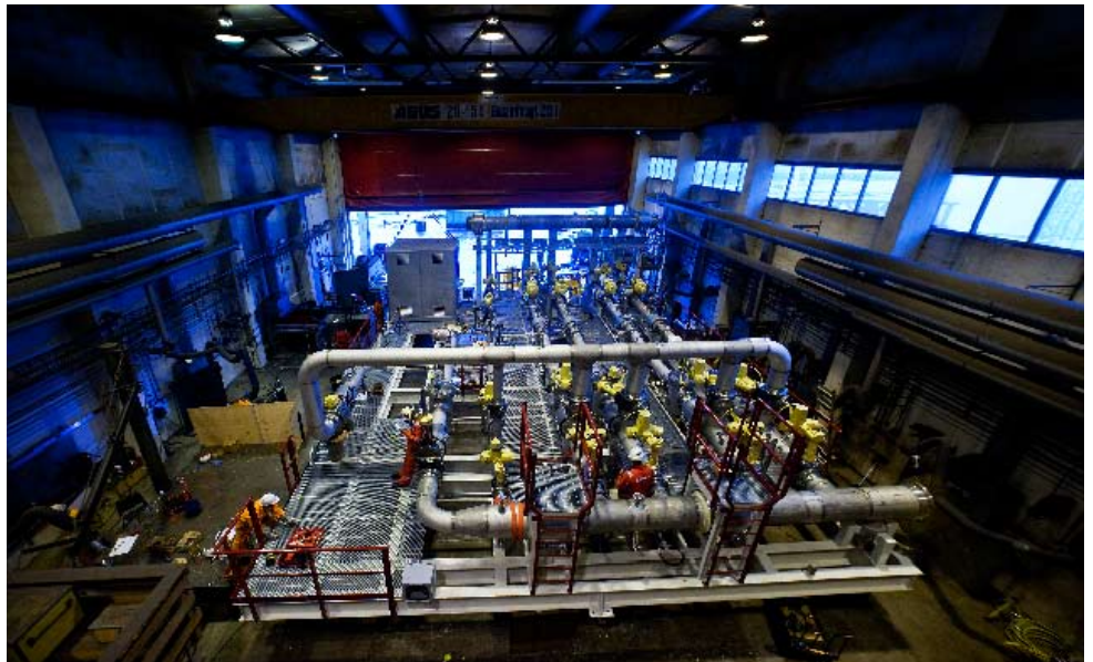
Metering skid i hallen.
